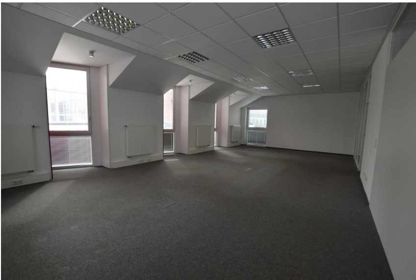
Odenwalddecke mit Grundbeleuchtung
