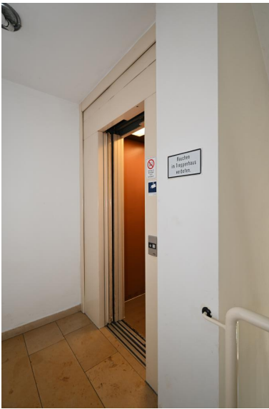
Aufzug von UG bis DG
